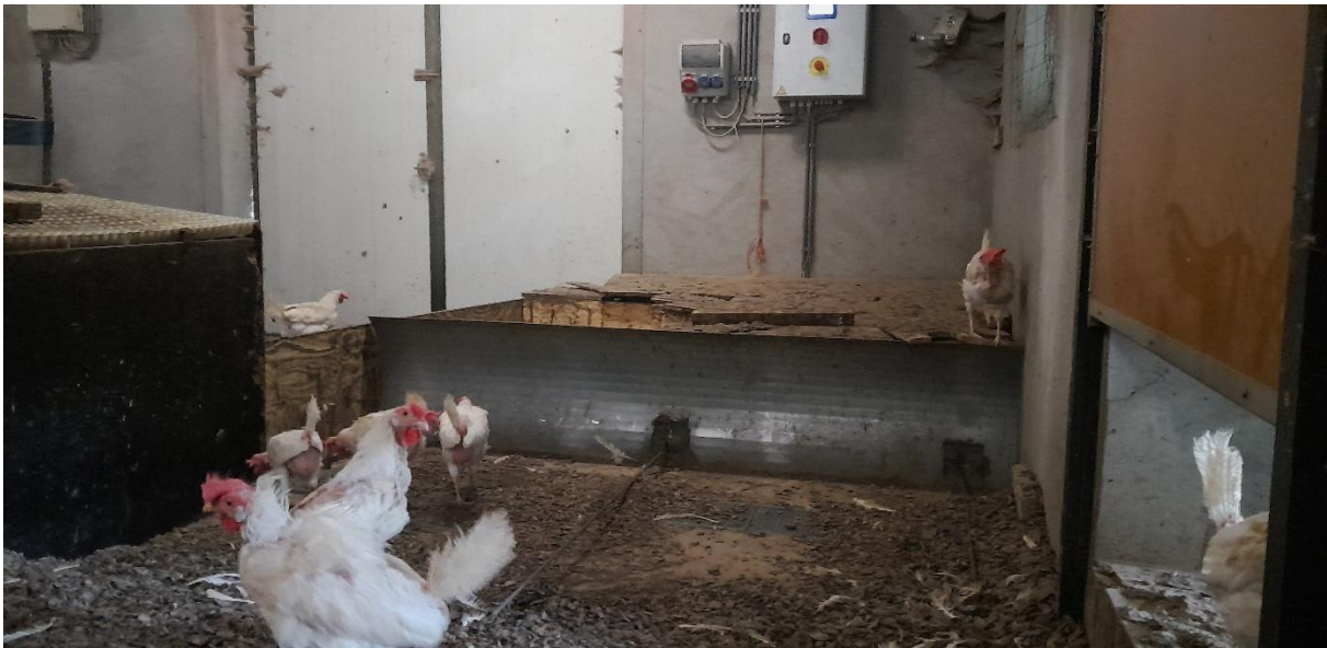
Figuur 4: Opstelling van de mestschuifel-aandrijving, met voorin in grijs de keerwand, en daarachter de aandrijving en kabelwielen onder een houten kast. Bovenin de elektra-voorziening en besturingskast.
